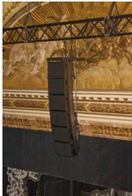
Sechs CDR 210 F aus der Cohedra-Serie sorgten für das Bassfundament über der Bühne
