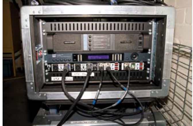
LAB.GRUPPEN-Endstufen und Firnet-Controller im Amprack
